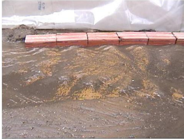
Figura 17. Ondulación de superficie en el sector final del muro, cerca del desborde
