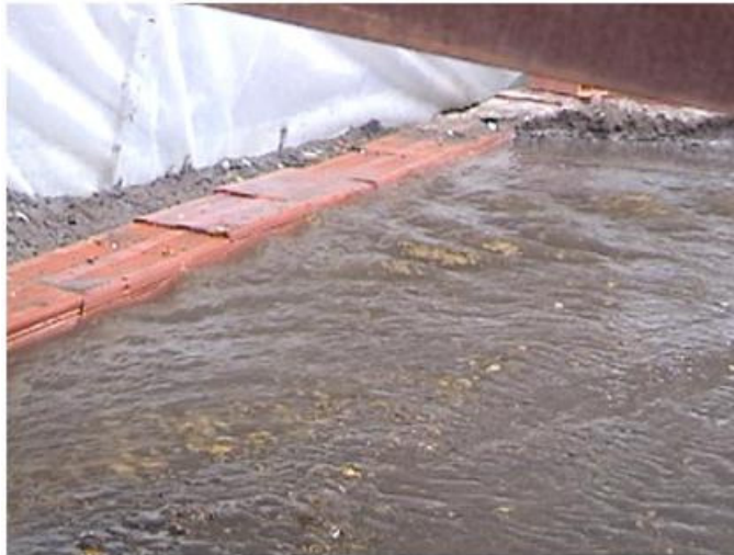
Figura 15. Superficie ondulada y desborde en el primer sector del muro, aguas arriba
