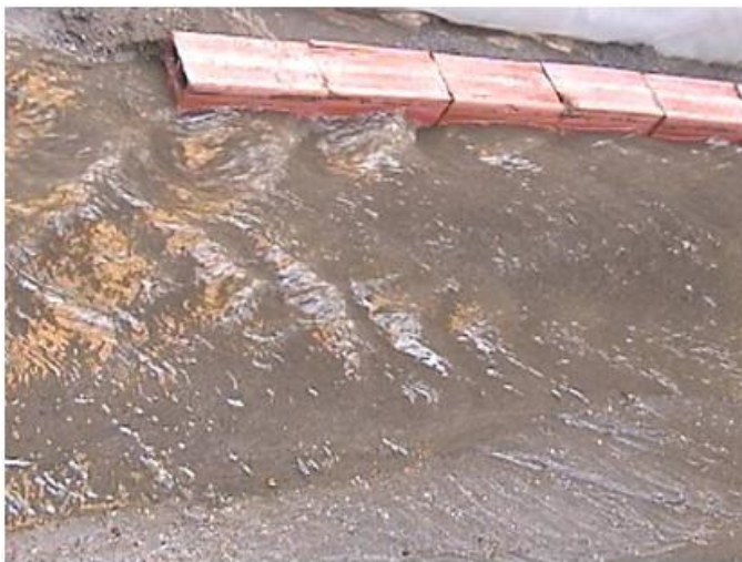
Figura 16. Ondulaciones de superficie en el sector final del muro, aguas abajo
