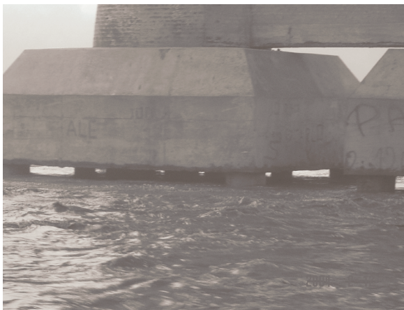
Foto 1.- Descalce de las pilas del Puente Carretero por descenso del cauce del Río Cuarto.
