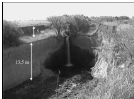
Figura 2.- Vista de la cárcava previa a la obra (Febrero de 2001)
