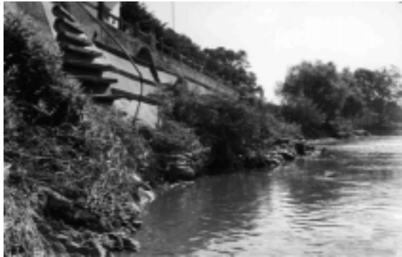
Figura 3.- Sector del INALI afectado por el deslizamiento.
