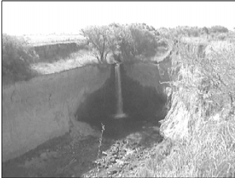
Figura 2: Vista desde aguas abajo de la cabecera de la cárcava (Febrero de 2001).
