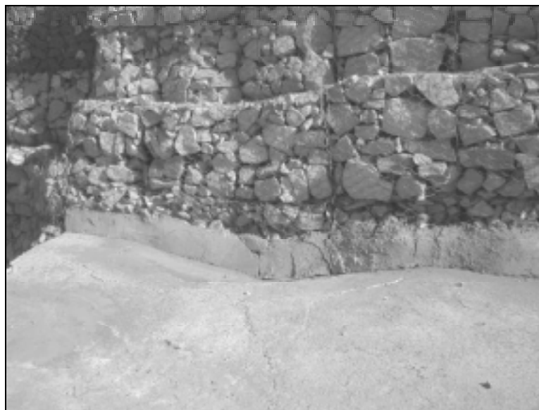
Figura 14: Deformaciones de los muros de gaviones.
