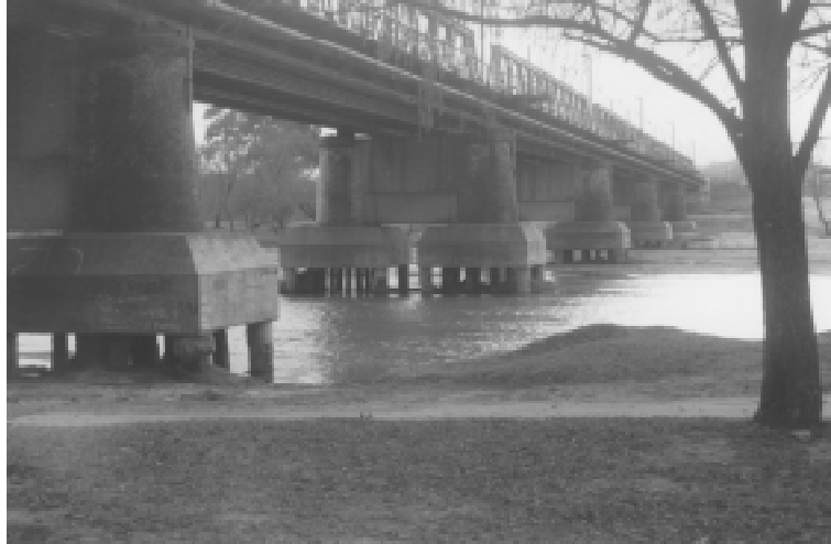
Figura 1: Descalce de las pilas del Puente Carretero por descenso del cauce del Río Cuarto.
