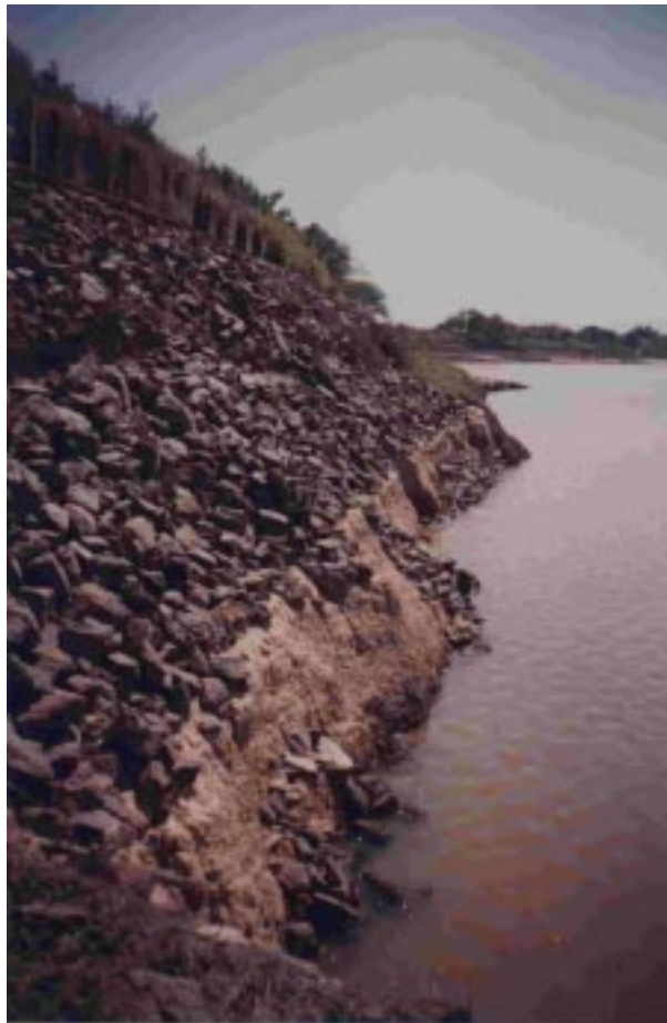
Figura 6.- Protección colapsada de la defensa de Cayastá relevada en el año 2001
