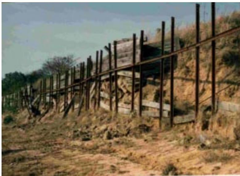
Figura 4.- Sección típica de la obra de protección destruida (1988)
