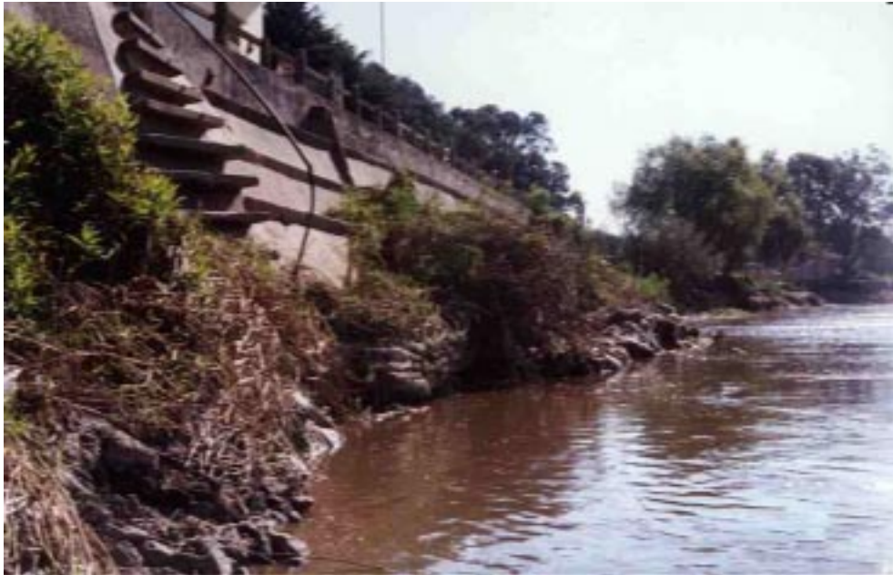
Figura 3.- Sector del INALI afectado por el deslizamiento.
