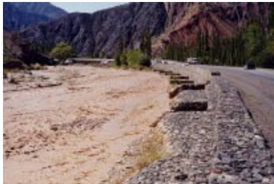
Figura 9.- Defensa marginal del río Toro – Protección del terraplén de la ruta Nac. 51 con botadores de refuerzo.
