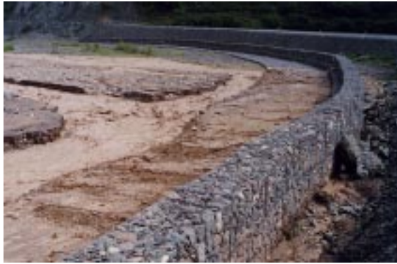
Figura 7.- Defensa marginal del río Toro – Protección del terraplén de la ruta Nac. 51
