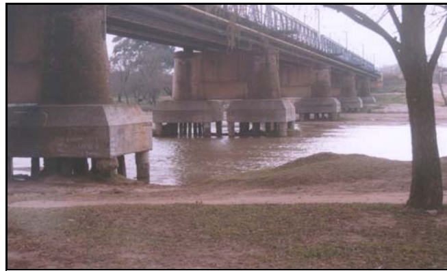
Figura 1.- Descalce de pilas del Puente Carretero por descenso del cauce del Río Cuarto.
