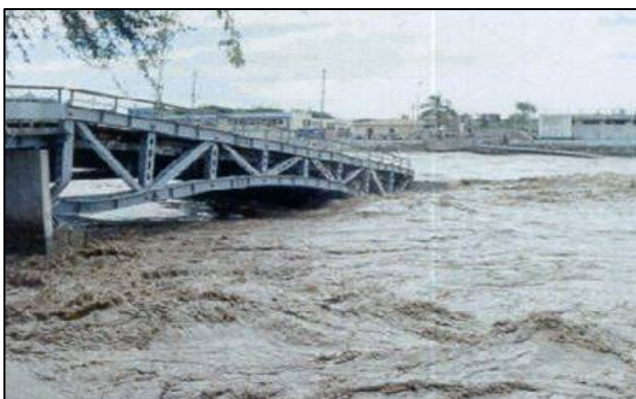
Figura 1.- Colapso del Puente Viejo (1998), río Piura, Perú.
