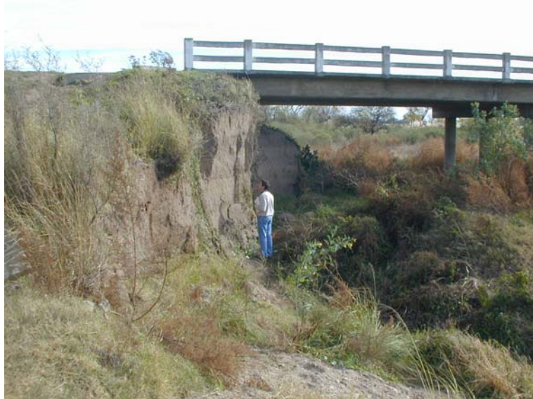
Foto 2 – Detalle de erosión lateral
