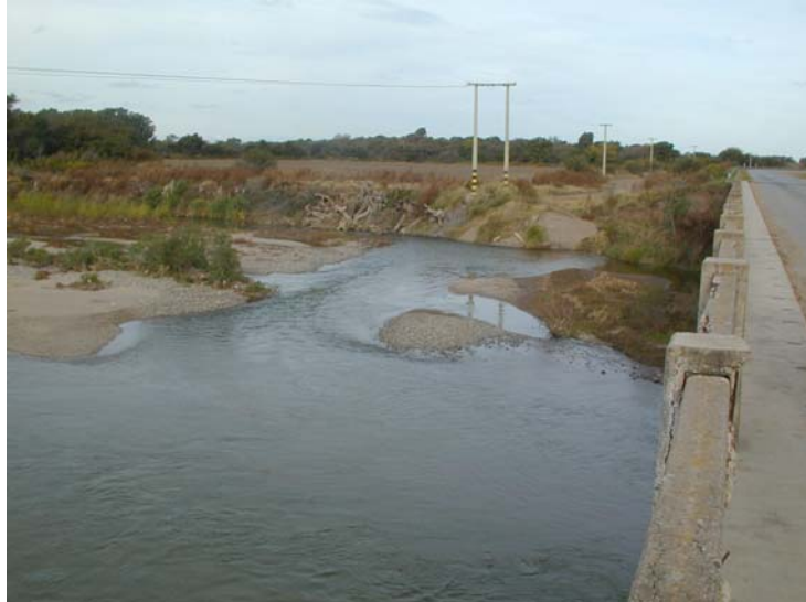
Foto 1 – Brazo del río impactando en margen derecha del río, aguas abajo del puente
