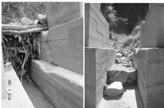
Figura 4.- Vista cercana de la ranura #8 de la Presa El Cojo, mostrando grado de obstrucción en el 2005 y 2007. Se aprecia el nuevo cauce formado al fondo de la foto.
