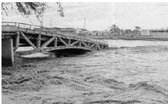
Figura 1.- Falla del Puente Viejo, 1998, río Piura, Perú.
