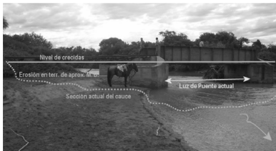
Figura 3.- Erosiones en Puente sobre Arroyo Cabeza de Vaca
