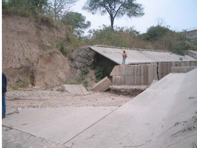
Figura 17.- Arroyo Zanja Honda. Otra vista de los procesos erosivos sobre margen derecha en la obra de descarga situada inmediatamente aguas abajo del puente sobre la R.N. 34.
