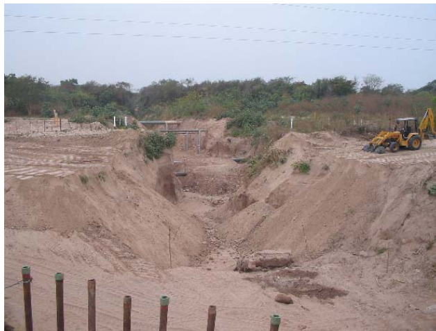
Figura 21.- Arroyo NN ubicado al norte de A° Zanja Honda y al sur del A° Yariaguarenda. Fotografía tomada desde la R.N. 34 hacia aguas abajo. Se observan algunos trabajos de movimiento de suelos aparentemente realizados por las empresas que operan los gasoductos y poliductos destapados que se aprecian en segundo plano.
