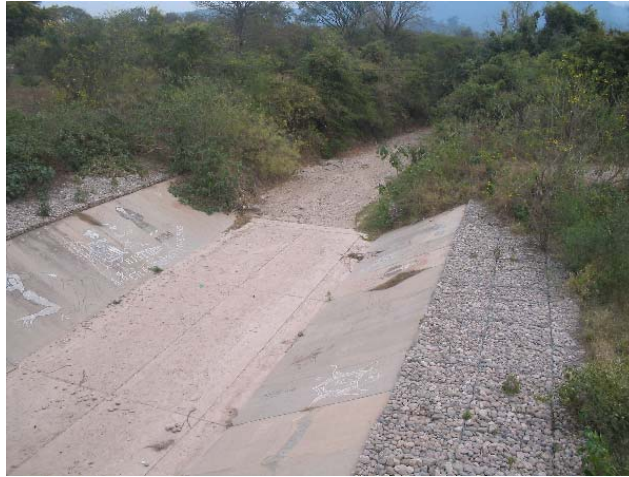
Figura 14.- Arroyo Zanja Honda. Revestimiento del cauce con hormigón en el segmento de aproximación inmediatamente aguas arriba del puente sobre la R.N. 34.
