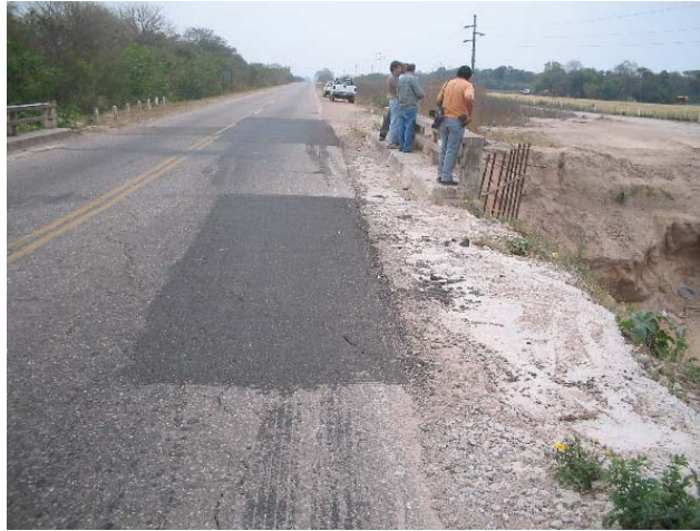
Figura 22.- Arroyo NN ubicado al norte de A° Zanja Honda y al sur del A° Yariaguarenda. Vista de los daños producidos por lo procesos erosivos sobre el paquete estructural de la R.N. 34 en ambas márgenes, con las reparaciones de la carpeta asfáltica.
