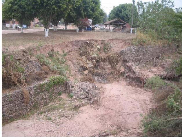
Figura 12.- Arroyo Cuña Muerta inmediatamente aguas arriba del puente sobre la RN 34. Se observa un importante proceso de erosión de márgenes (MD) que ha llevado a la destrucción de la obra de protección conformada en muro de gaviones. El estribo de margen derecha (Sud) se encuentra en una situación de alta vulnerabilidad potencial para el próximo período de lluvias en la región. Este punto se sitúa a unos 800 m aguas abajo del cruce de las vías del FCCGB y se observa como está evolucionando la sección transversal.
