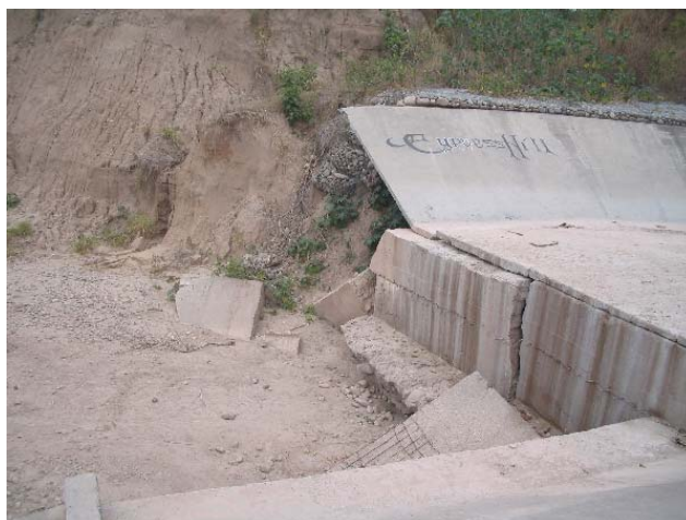
Figura 16.- Arroyo Zanja Honda. Detalle de la obra colapsada aguas abajo de la sección del puente sobre la R.N. 34. Se observa el descenso del nivel del lecho y el desnivel existente (del orden de 2 metros) que ha generado la destrucción de la platea, con severos procesos erosivos en ambas márgenes. La amenaza a la estabilidad del puente es significativa ante la eventualidad de incremento en los caudales líquidos esperables en la próxima estación estival.
