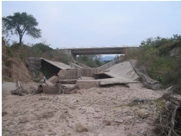
Figura 18.- Arroyo Zanja Honda. Vista general (hacia aguas arriba) de la obra destruida, tomada desde el centro del cauce aguas abajo del puente. Resulta necesario y urgente reparar esta obra e instrumentar acciones de protección de la misma para evitar el colapso del puente.
