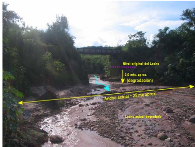
Figura 13.- Arroyo Cuña Muerta inmediatamente aguas abajo del cruce de las vías del FCCGB. Se observa claramente la diferencia entre la sección transversal actual del cauce y la sección hidráulica del puente. Los efectos de contracción son altamente significativo y se aprecian importantes procesos erosivos en los pies de estribos. También puede apreciarse un precario umbral de fondo aguas abajo del puente (a la altura de la línea que acota el ancho). Se recomienda incrementar la sección hidráulica.
