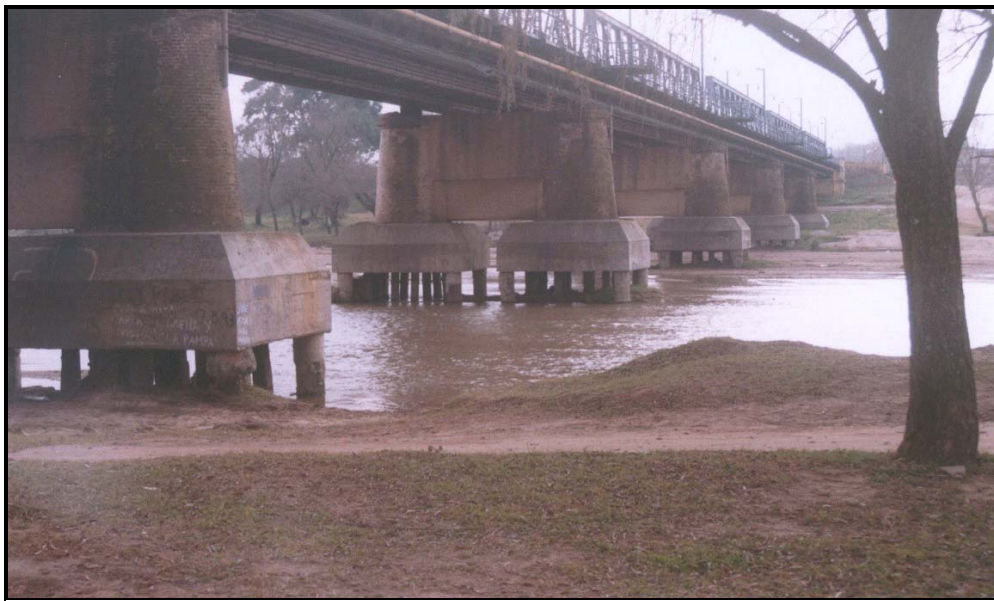
Figura 8.- Descalce de pilas del Puente Carretero por descenso del cauce del Río Cuarto (Año 2001).
