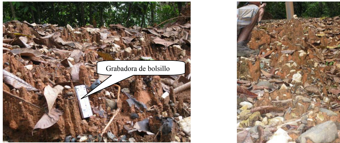
Figura 15.- Fotografías, erosión en espaldones y taludes expuestos.
