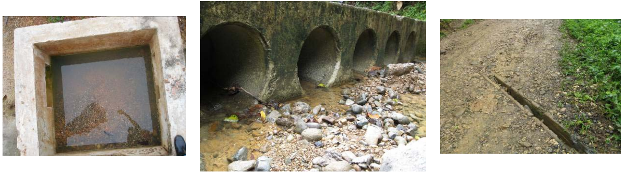
Figura 19.- Fotografías, Sistemas artificiales afectados por los procesos erosivos.
