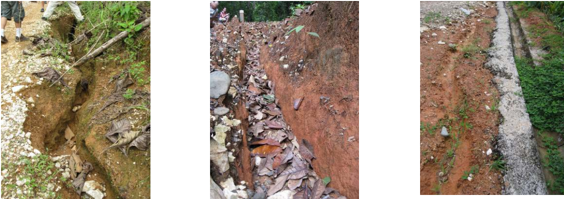
Figura 17.- Fotografías, formación de cárcavas por infraestructura deficiente o inexistente.
