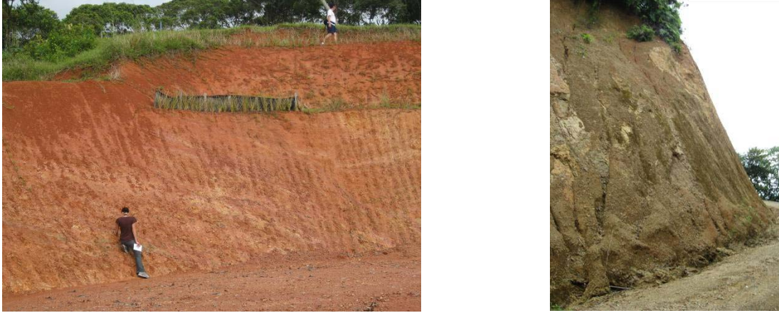
Figura 16.- Fotografías, taludes grandes expuestos.
