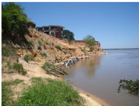
Figura 5.- Procesos erosivos en la zona del hotel de Turismo de Empedrado.
