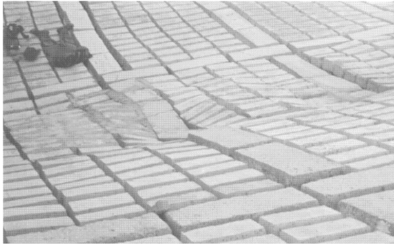
Figura 6: Falla geotécnica local del plano de apoyo
