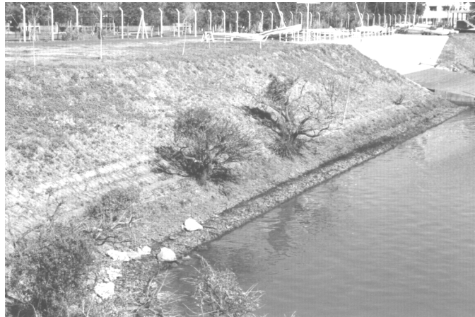
Figura 10: Estado actual de una obra de protección con bloques en el país realizada hace aprox. 20 años.
