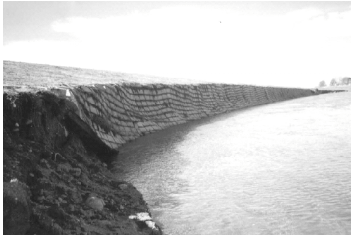
Figura 3: Inutilización de la protección por inestabilidad geotécnica del talud
