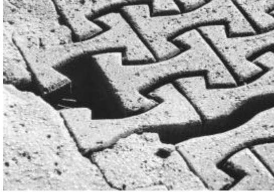
Figura 9: Bloques de hormigón deteriorados por el medio agresivo
