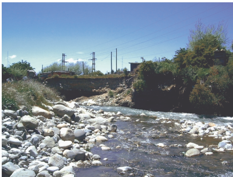
Figura 8.- Sector erosionado de margen derecha con deslizamiento del talud
